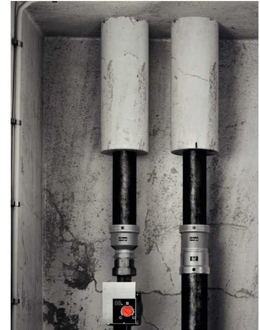
Hoogbouw Geperste stalen stijpleidingen
