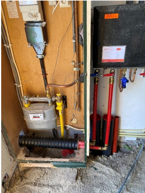
PEX Twinpipe naar losse aansluitleiding
