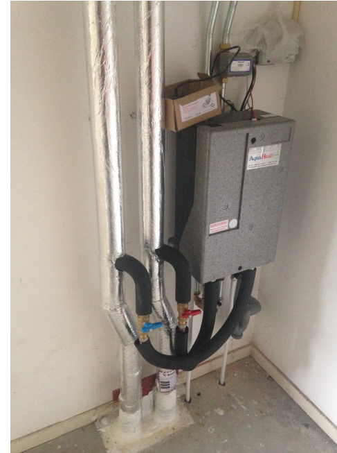
Hoogbouw nageïsoleerde stijpleidingen Set naast stijpleiding
