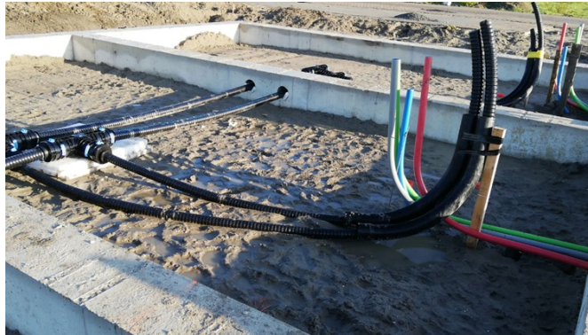
Single PEX in kruipruimte NB Koppeling in kruipruimte ongewenst
