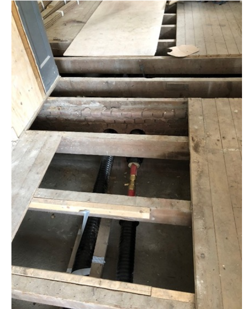
PEX door kruipruimte NB Koppeling in kruipruimte ongewenst
