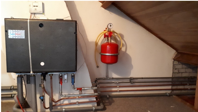
CV leidingen in staal geperst Warmtapwater in koper
